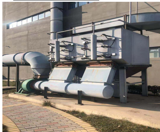
生产废气净化设施
