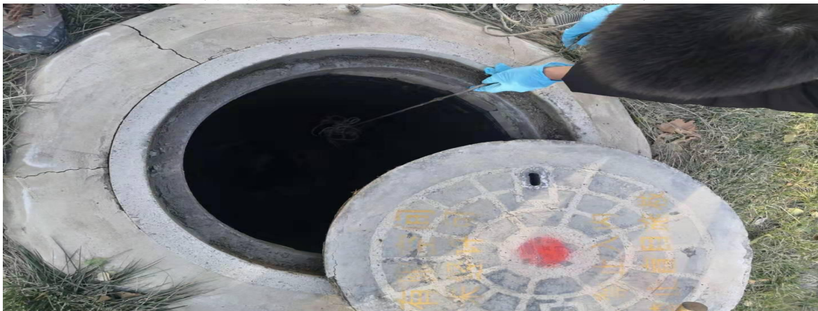
项目东侧生活污水排放口 图4.1-1 本项目化粪池排口
