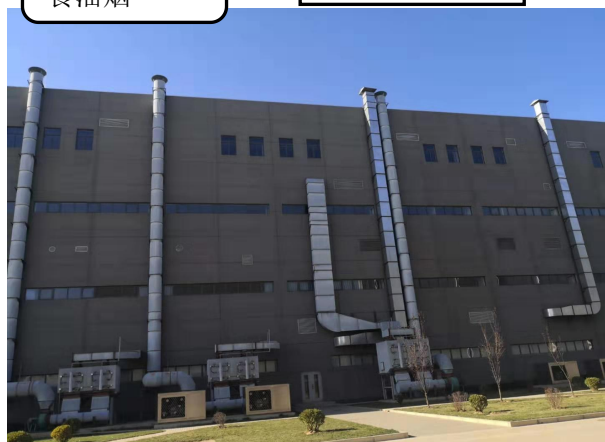
生产废气排放口
